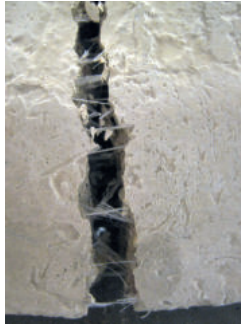
Abb. 7.7: Rissbild Kunststofffaserbeton mit Strux 90/40
